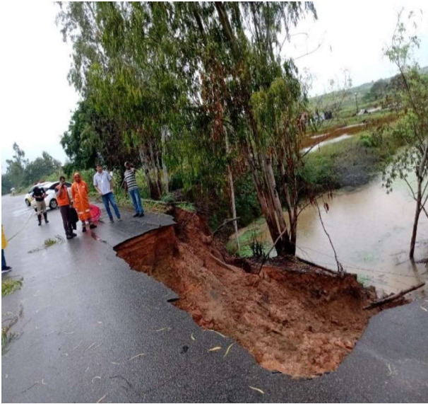
Resposta em abertura de cratera na rodovia SE 200
